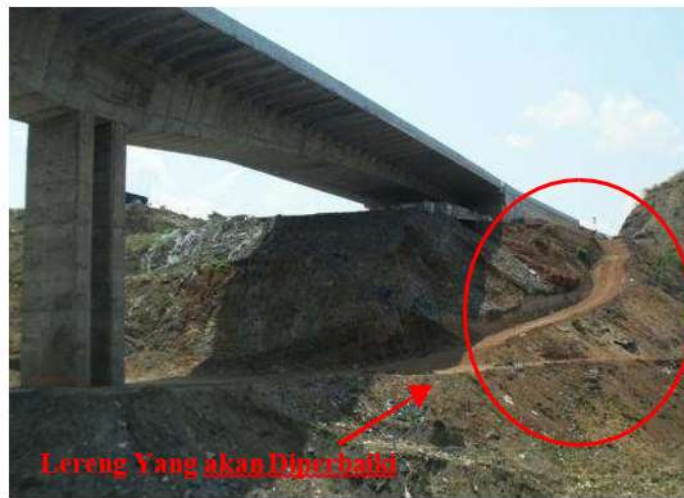
Gambar 3. Daerah sisi kanan Abutment A2 yang akan diperbaiki (Sumber : Dokumentasi di Proyek)
