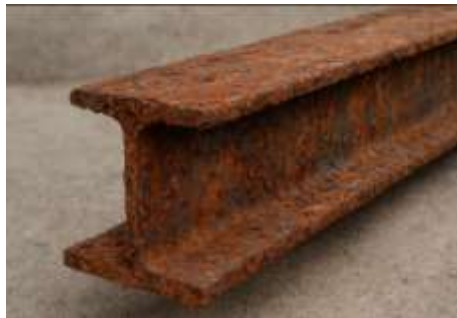
Gambar 2. Korosi pada baja IWF
